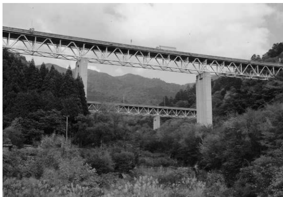
橋梁振動を用いた発電技術の開発
