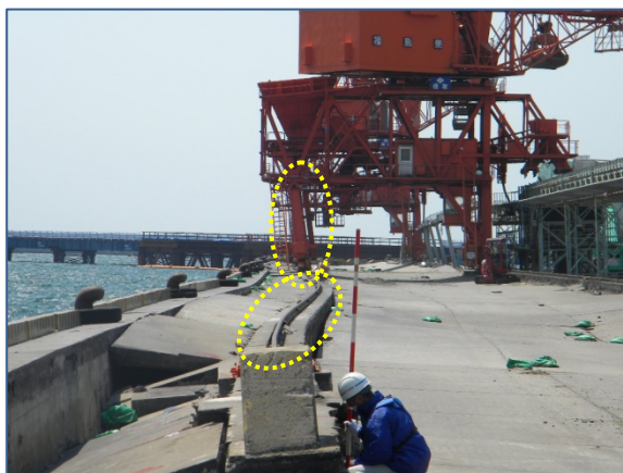
荷役機械のレール蛇行と傾斜
