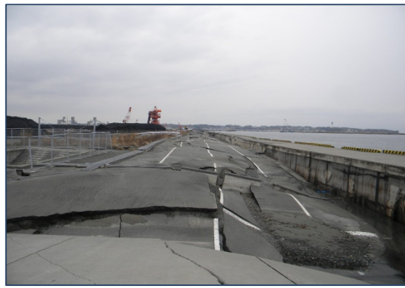
護岸背後の沈下
