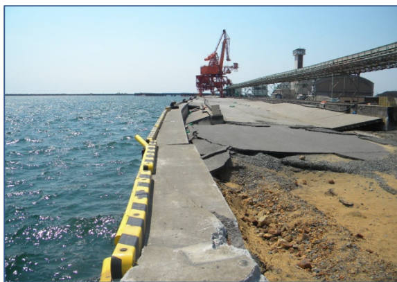
岸壁法線のはらみだし(1m以上)
