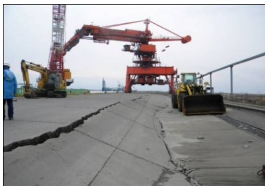
岸壁背後が陥没
