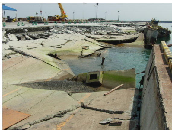
被災した岸壁
